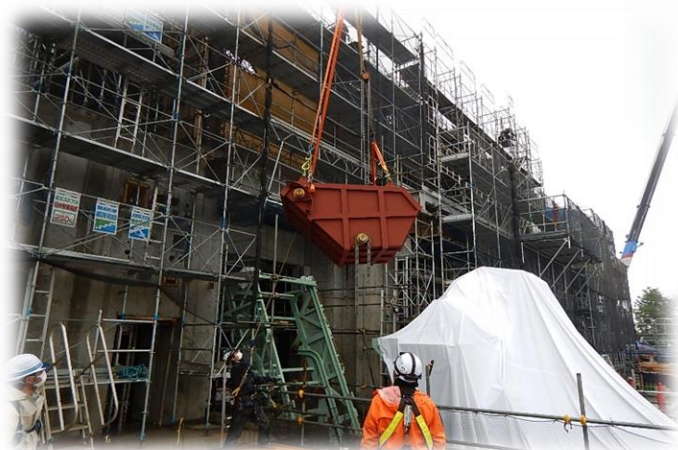
● 搬送装置バケット取込中
