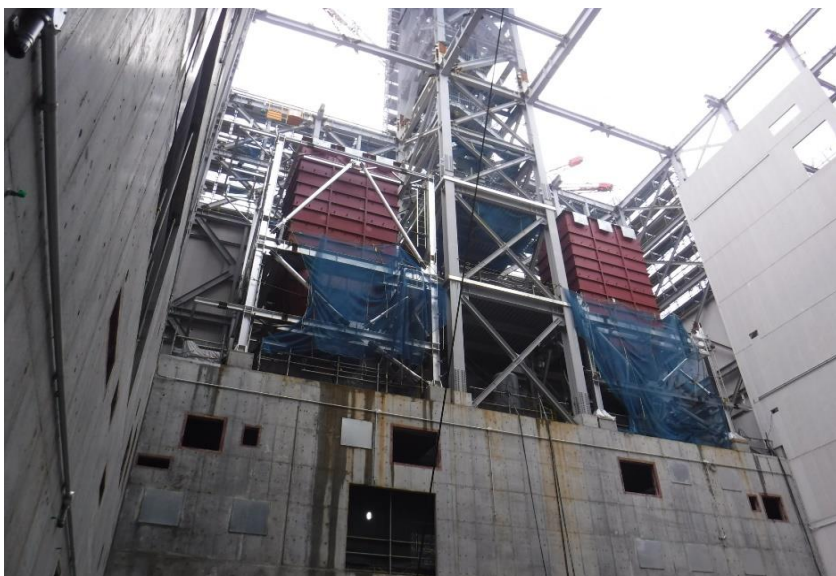
●1工区ろ過式集じん器取り込み状況
