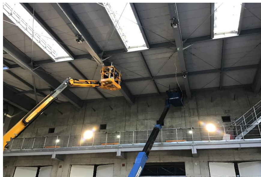
●3工区プラットホーム天井照明器具取付状況
